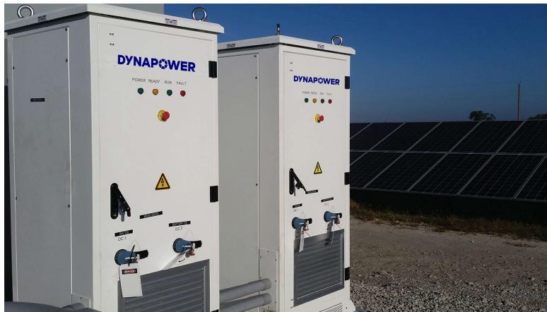
Figura 32. Fotografía de un equipo de Dynapower, concebido para almacenar en baterías la energía eléctrica excedente de una planta fotovoltaica y volcarla a la red eléctrica en momentos en los que la generación fotovoltaica directa sea baja. El equipo incorpora convertidores CC/CC e inversores (convertidores CC/CA).
